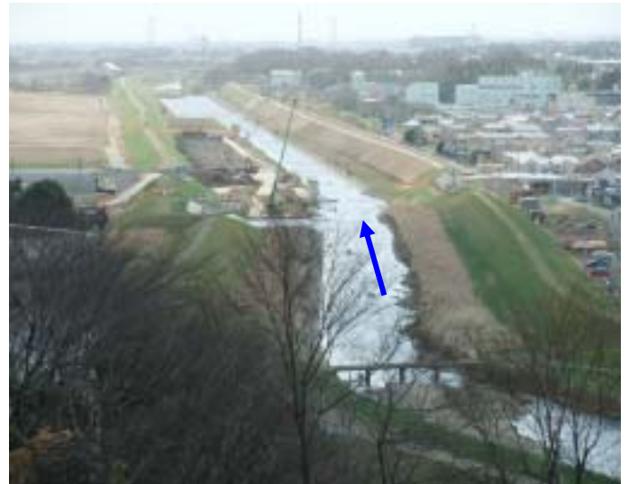
東松山市(右岸)吉見町(左岸)の行政界を流下する市野川。 県道27号城南新宿橋(現在は、竣工済)の工事風景。 下流の一部は低水路が拡幅工事済み。堰は、移動計画。
