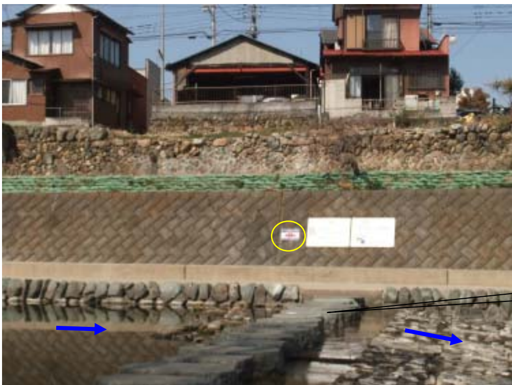
右側の看板 2 枚は、東松山県土整備事務所の「水深注意の看板」。
