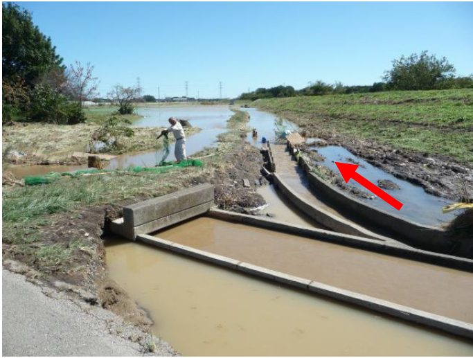
■都幾川矢来用水路の決壊、田畑の冠水状況（11時）。
