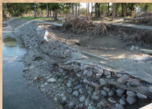
H29年度まるごと再生による自然石護岸の決壊。 「くらかけ清流の郷 右岸堤防」
