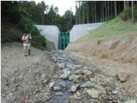
えんてい 完成した上流砂防堰堤(高さ8m、下流側より望む)
